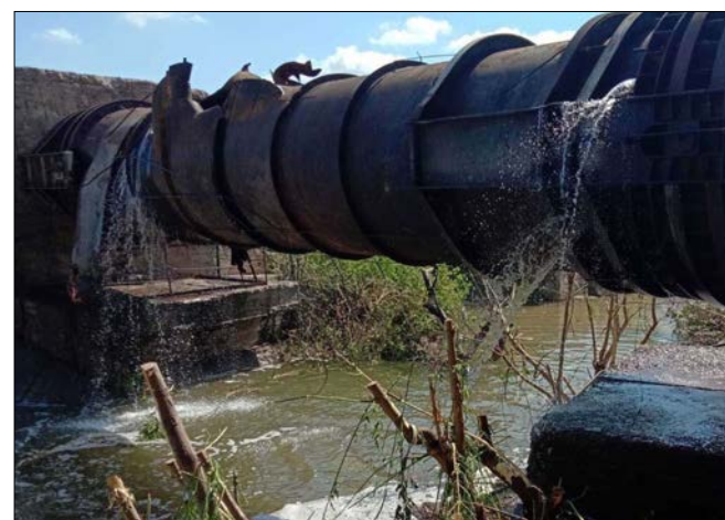
Пошкодження системи водопостачання у результаті обстрілів, 22.07.2020. Фото UNICEF
