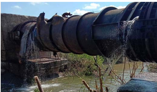
Пошкодження системи водопостачання у результаті обстрілів Фото UNICEF, 22.07.2020.
