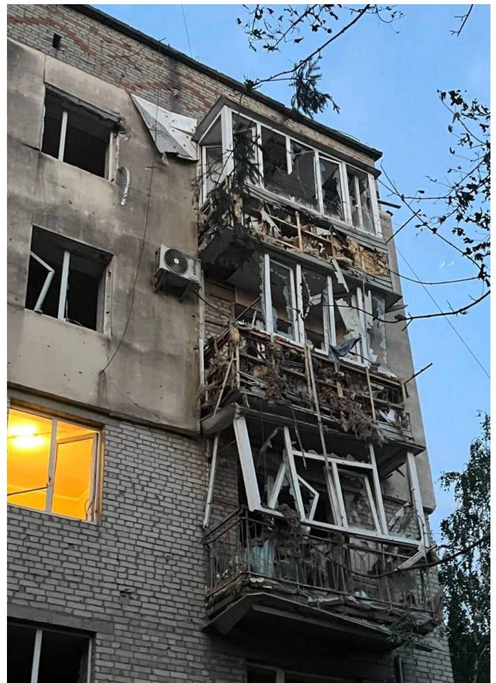
Фото 2: Пошкоджена багатопверхівка у Сумській обл.
