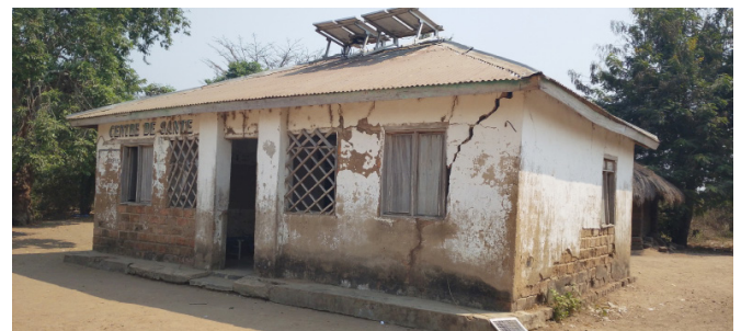
Centre de santé présentant une précarité structurelle à la suite des inondations, tout en demeurant opérationnel (bloc Kalenga ya Mayi, 07/04/2026)
