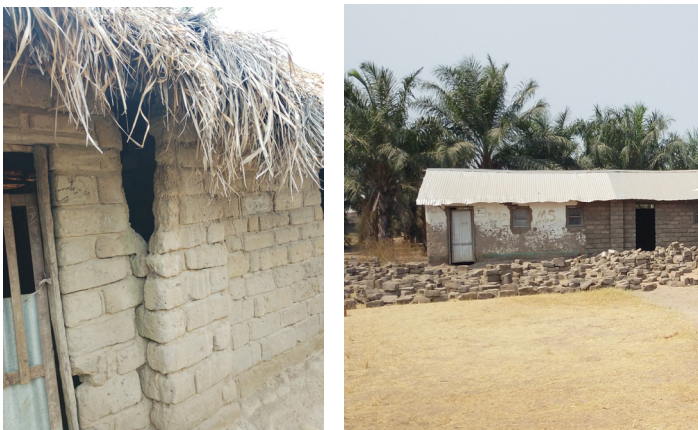
Écoles secondaires présentant des dommages aux murs causés par les inondations (à gauche, bloc Katanga, 04/07/2026 ; à droite, bloc Chengé, 07/05/2026)
