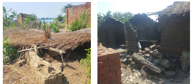
Photos illustrant différents types de dommages structurels aux habitations, notamment des dommages aux fondations (à gauche) ainsi qu'aux murs et à la toiture (à droite) (bloc Regie, 07/06/2026)
