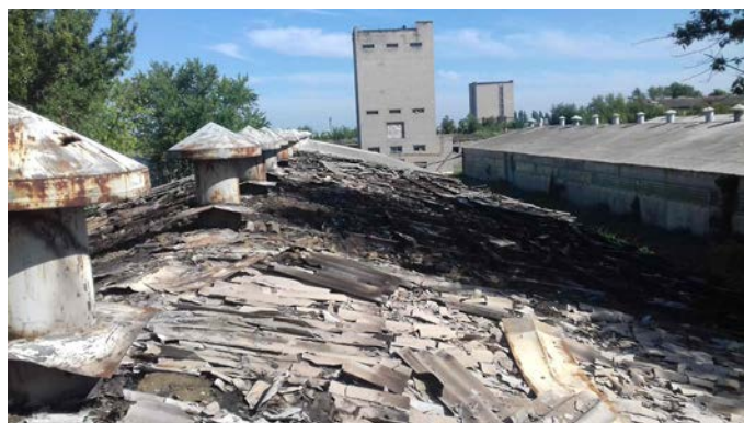
Будівлі Бахмутського аграрного союзу, пошкоджені пожежею, 03.08.2018 фото ДСНС
